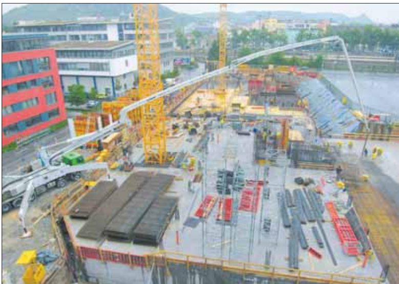
Die Rohbauarbeiten am Hegau Tower, einem der wichtigsten Zukunftsprojekte Singens, gehen zügig voran. Das Untergeschoss mit den Technikräumen und der späteren Tiefgarage steht kurz vor der Fertigstellung. Die aufsteigenden Bauteile (wie Treppenhäuser und Fahrstuhlschächte sowie die Stützen für die Decke des Erdgeschosses) werden derzeit mit Bewehrungsseisen versehen, eingeschalt und betoniert.
