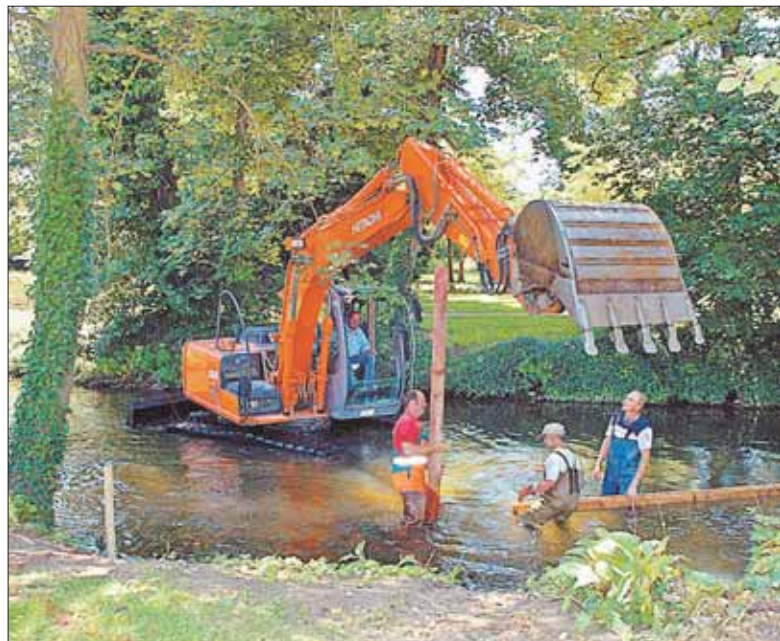
Unter Einsatz eines gemieteten Baggers mitten im Fluss haben Arbeiter des städtischen Bauhofs mit den Vorbereitungen für den Anschluss der neuen Stadthalle Singen an die Aach begonnen. Ein kleiner Flussabschnitt muss zunächst trockengelegt werden, um dort die Entnahmestelle für die Wärmepumpe der Halle zu errichten.
