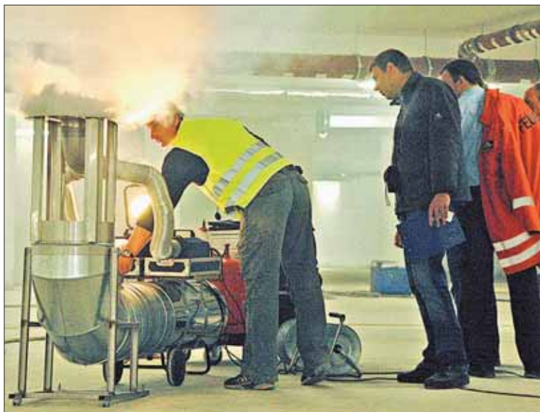
Die Rauch-Entlüftungsanlage der Tiefgarage unter der neuen Stadthalle Singen wurde intensiven Tests unterzogen und bestand diese mit Bravour. Eine speziell für solche Zwecke konstruierte Maschine produzierte an verschiedenen Standorten in der Tiefgarage zur Brand-Simulation eine Art „Theaternebel“.
