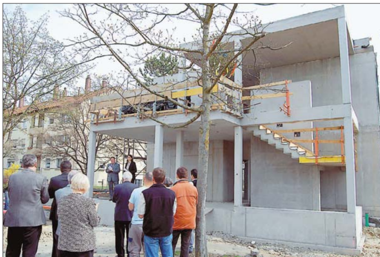
Nur wenige Tage nachdem die Schillerschule (Grund- und Hauptschule) ihr 50-jähriges Bestehen feierte, wurde das Richtfest des Erweiterungsbaus begangen. Mit dem Anbau, der voraussichtlich im Juli fertiggestellt ist, kann die Schule ihr Ganztagsangebot in vollem Umfang umsetzen. Auf zwei Stockwerke mit insgesamt 485 Quadratmetern entstehen u.a. Lernwerkstätten, ein Lese- und ein Spielraum, ein Aufenthaltsraum und neue Sanitärräume mit Behinderten-WC. Die Kosten für 1972 Kubikmeter betragen 950 000 Euro; davon bekommt die Stadt einen Zuschuss vom Regierungspräsidium in Höhe von 196 000 Euro.
