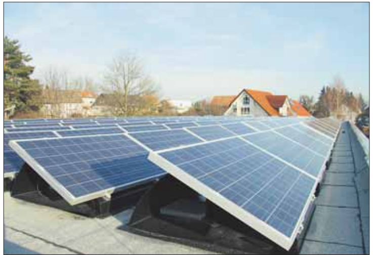
Auf dem Dach der Bohlinger Schule wurde auf mehreren kleineren Flachdachflächen eine Photovoltaik-Anlage installiert. Leistung: Insgesamt 44,64 Kilowatt Peak (1 kWp entspricht 1000 Watt), was etwa den Strombedarf von zehn Vier-Personen-Haushalten deckt.
