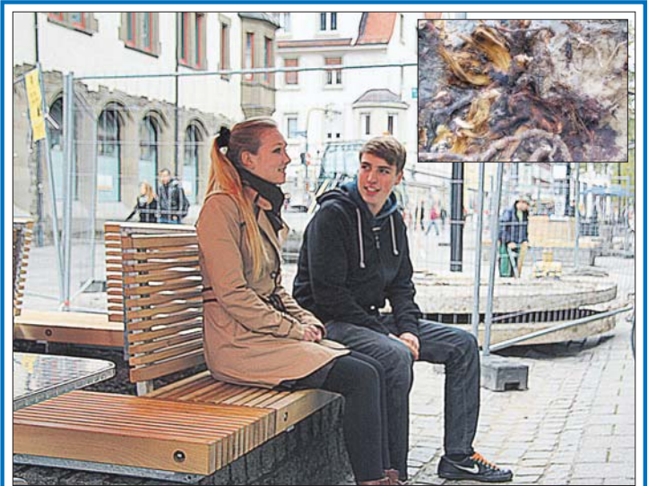
Die Arbeiten an der August-Ruf-Straße gehen voran. Jeden Tag kommen neue Elemente hinzu, wie zum Beispiel die Sitze. Im Zuge der Umbauarbeiten zeigten sich erst die ersten Schäden an den Robinien (kleines Bild), die nun allesamt durch die schmalblättrige Esche „Raywood“ ersetzt werden.
