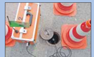
Suche nach einem Leck in den Wasserrohren mit moderner Messtechnik.
