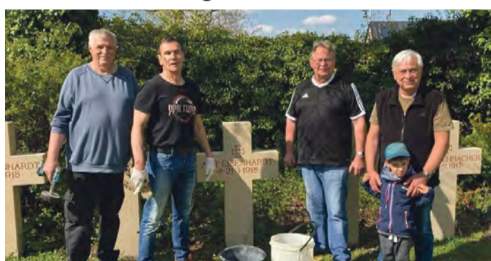
Die „Alt-Pfadis“ legen sich für die Sanierung der Kreuze des Ehrenfriedhofs in Steißlingen mächtig ins Zeug.
